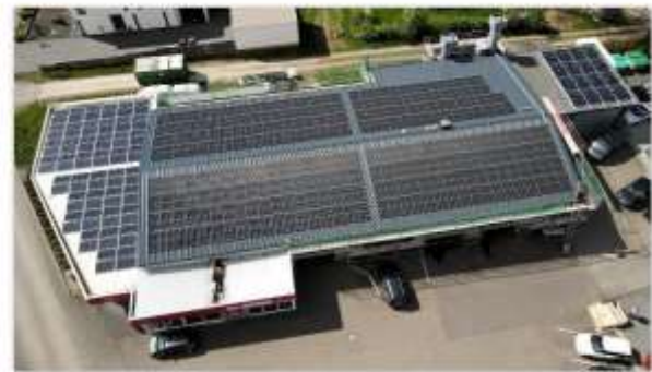
Auto Metzen, Monzelfeld (132 kWp Leistung) 32-kWp auf den Flachdächern (Inbetriebnahme 2019) 100-kWp auf dem Satteldach (Inbetriebnahme 2021)
